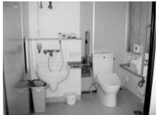
車いす・オストメイト対応のトイレ
